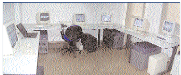
Figura 1. Sala de servidores.
